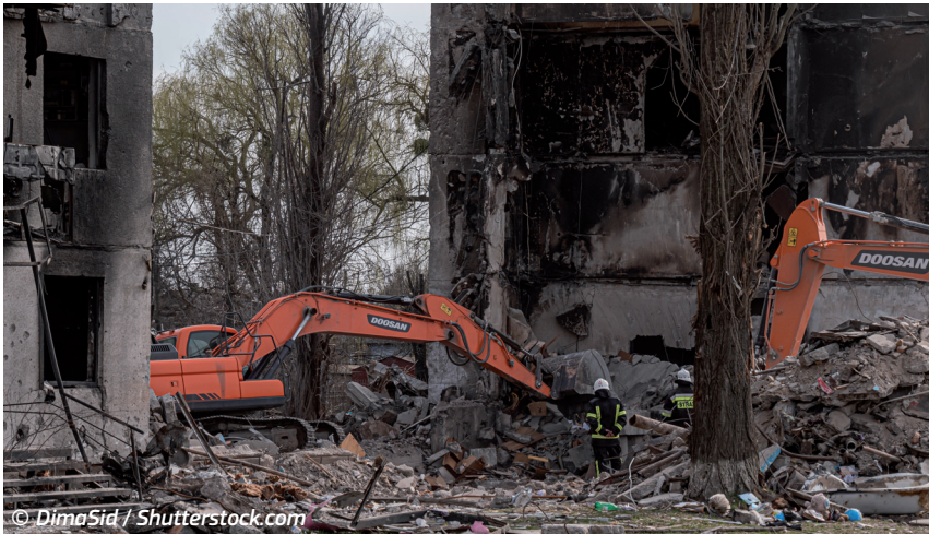
Aufräumarbeiten an einem zerstörten Wohnhaus im ukrainischen Borodyanka.
